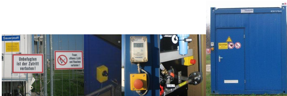
Abbildung 34 Umsetzung von Sicherheitseinrichtungen im Rahmen der Pilotversuche
